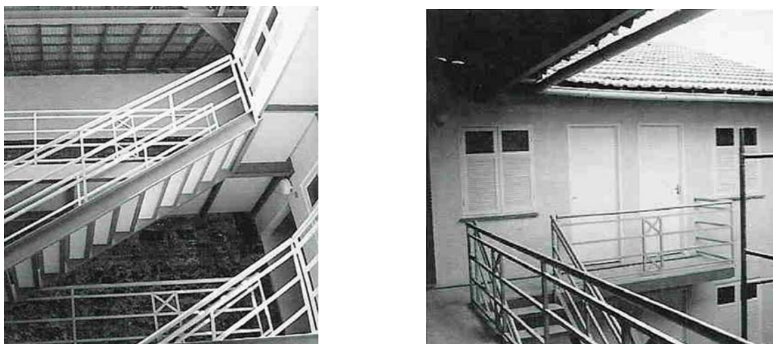
Figura 32 – Imóvel na Rua Sacadura Cabral, 295 antes e depois da reforma. Fonte: RIO DE JANEIRO, 2003.
