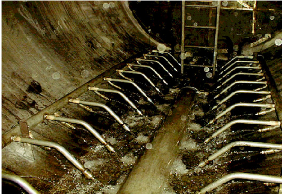
Figura 11 – Interior do separador de Troll Pilot, mostrando os bicos de jateamento d'água [7].
