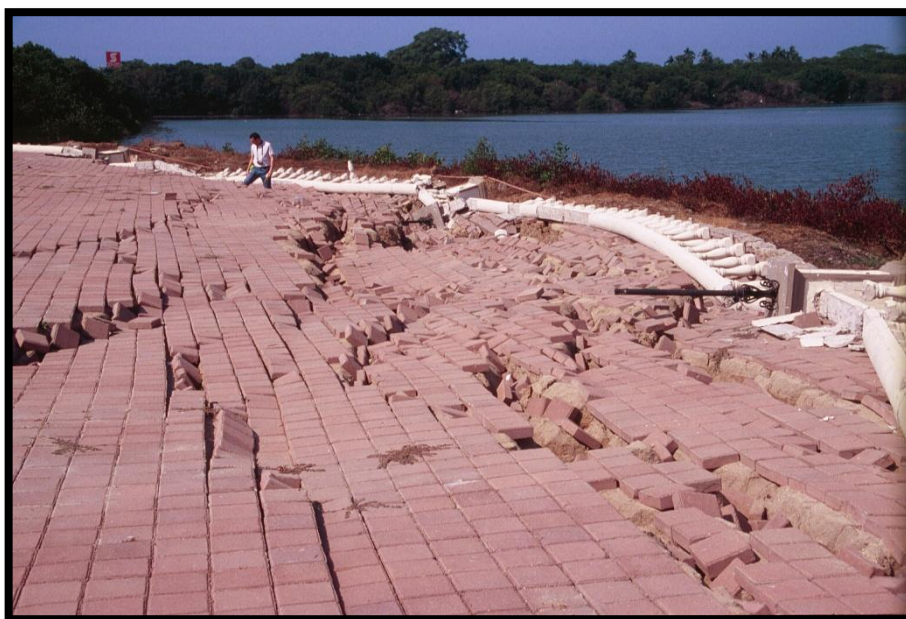
Figura 11 – Exemplo de expansão lateral (Cidade de Manzanillo, México) (Fonte: http://research.eerc.berkeley.edu/projects/GEER/GEER_Post%20EQ%20Reports/Tecoman_2003/c-land.html ).
