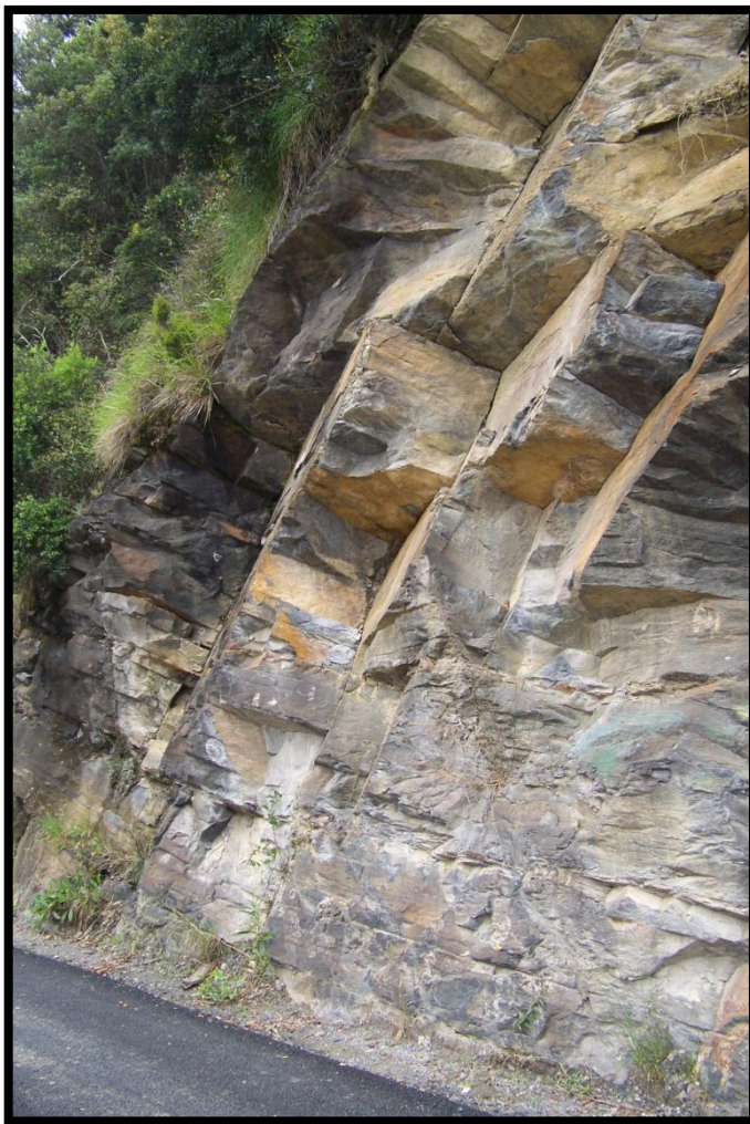
Figura 17 – Exemplo de escorregamento em cunha (Blumenau, Santa Catarina).
