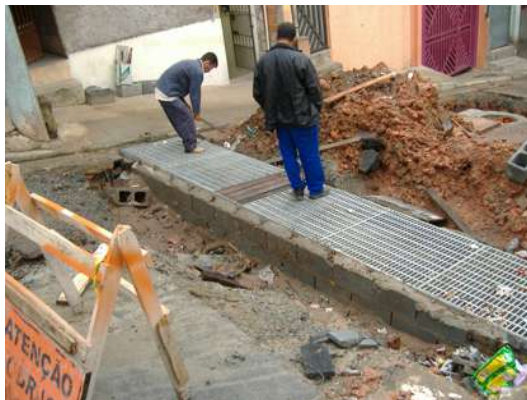
Foto 105 – grelha – Rua São Paulo (parte alta)
