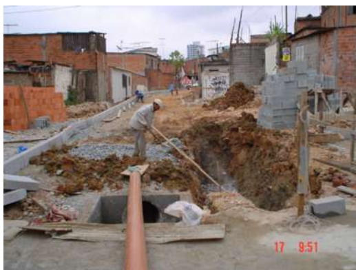
Foto 72 – redes de infraestrutura – rua 7
