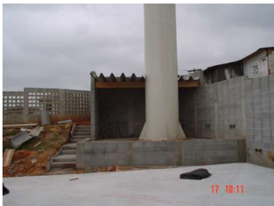
Foto 32 – abrigo da caldeira e caixa d' água
