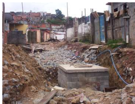
Foto 119 – redes de infraestrutura – rua 6
