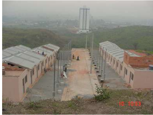
Foto 31 – autoconstrução – pav. superior; Fonte: L. Felipe / DEHAB/ SDUH/ PSA; set/ 2003.
