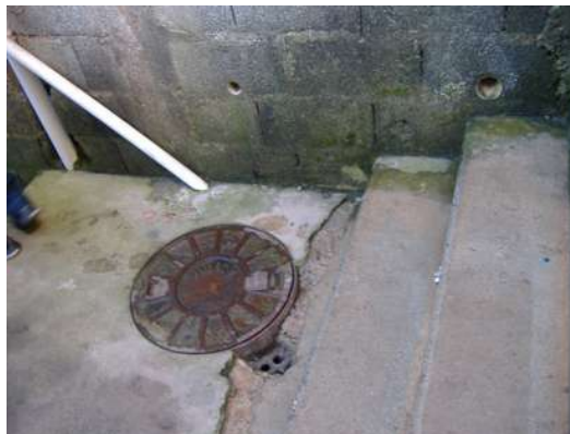
Foto 142 – quebra de pavimento – viela 42 (setor 1)
