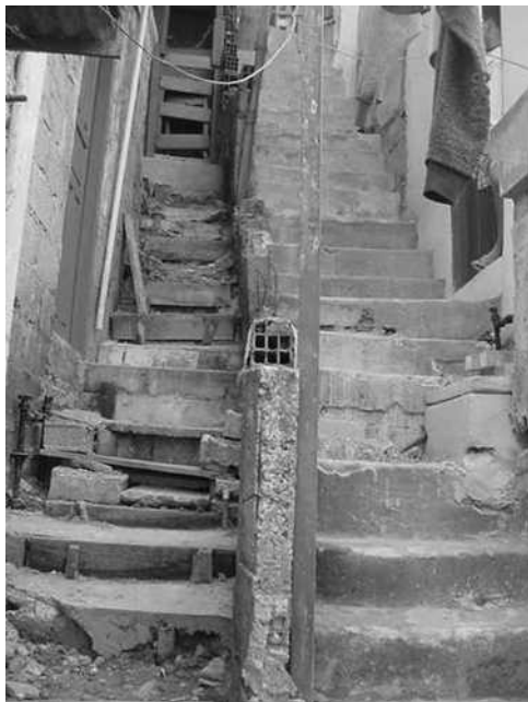
Foto 84 - (antes) – viela 129 Escadaria/ acessos Fonte: luís felipe / DEHAB/ SDUH/ PSA; 2003.
