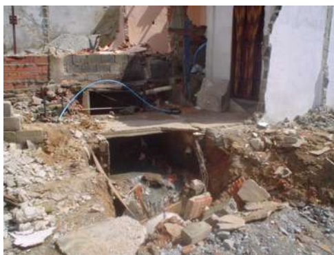
Foto 118 – casas sobre canal existente – rua 6
