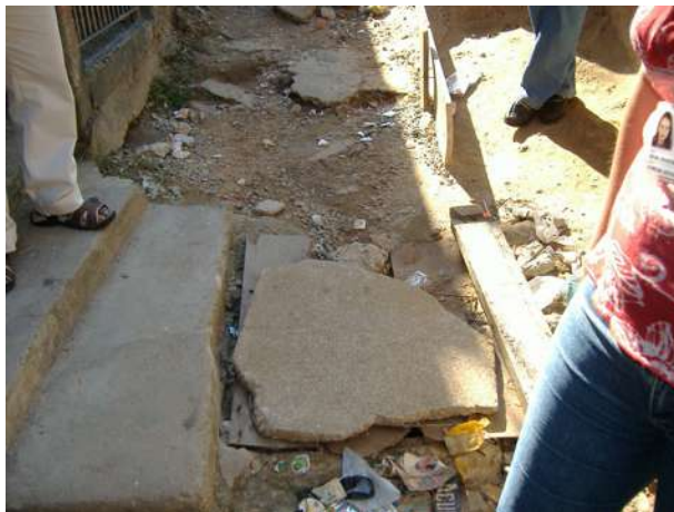
Foto 140 – Tampa de caixa quebrada – viela 83
