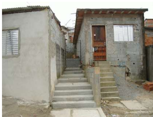
Foto 156 – viela sanitária – interligação na rua 6
