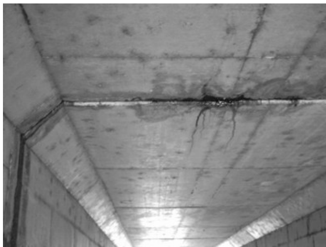
Figura 2.34- Segmento central do bueiro celular que sofreu recalque de 35mm (VERTEMATTI & MONTEZ, 2006).
