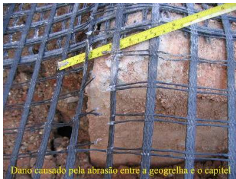
Figura 5.10- Localização e detalhe da geogrelha danificada devido à abrasão com o capitel (arquivo pessoal, NUNES, A.L.L.S.).
