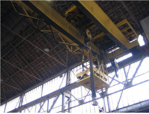
Os aparelhos reguladores situavam-se montados em uma cabina suspensa à ponte rodante, ao alcance imediato do manobrista do guindaste, como vemos na Fig. 76 . A cabina contava ainda com um quadro de mármore com as chaves, interruptores automáticos, voltímetro e amperímetro. RELATORIO nº. 52 da Directoria da Companhia Mogyana de Estradas de Ferro e Navegação para a Assembléa Geral de 25 de Junho de 1905, p. 176. Foto da autora (2007).
