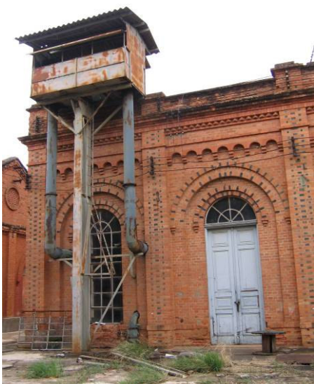
Na Fig. 45 vemos uma das laterais da usina geradora em que ainda remanesce parte do equipamento originalmente utilizado na produção de energia elétrica. Embora não tenha sido possível identificar a função de tal equipamento, vale notar a tecnologia construtiva utilizada, que uma vez mais se utiliza dos trilhos de trem, aqui para a execução de pilar, além do sistema de largos condutores — aéreo e também direcionado ao subsolo (no centro da porção inferior da imagem). Foto da autora (2007).
