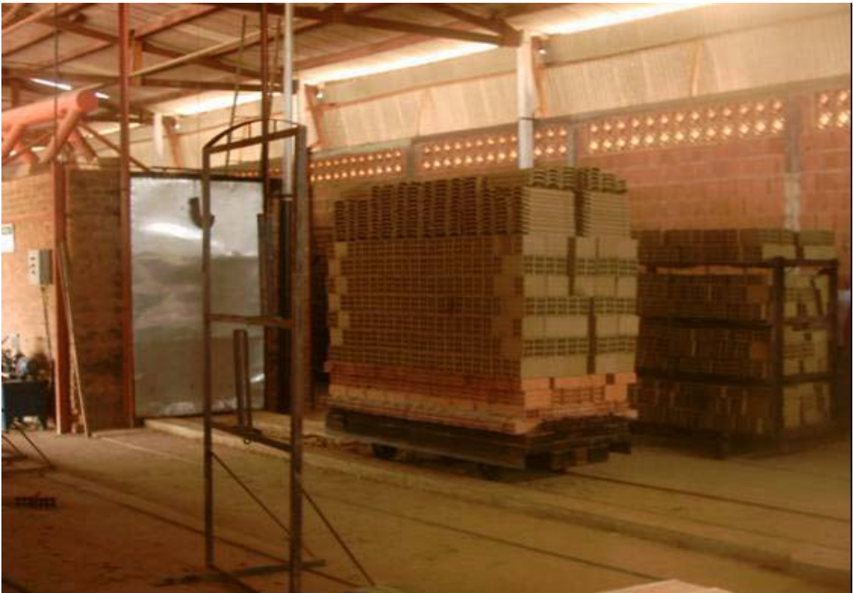
Figura 5.12 – Vagoneta e entrada do forno de túnel.
