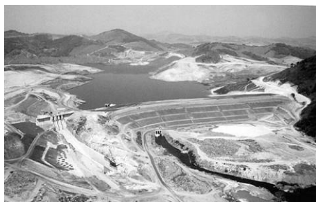
Figura 20 – Barragem do reservatório Jaguari em construção, nos anos 1970. Com este reservatório, o Sistema Cantareira avança sobre bacias de drenagem situadas em Minas Gerais.
