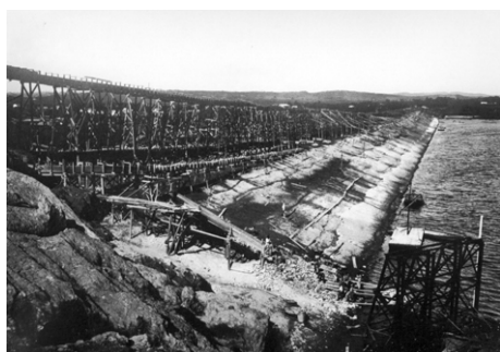
Figura 17 – Barragem do reservatório Guarapiranga em construção, no início do século XX. Projetado para a regularização de vazão na Usina Edgard de Souza, com a expansão acelerada da cidade, no final dos anos 1920, passou a servir também para o abastecimento público. Fonte: Solia, Faria e Araújo (2007).
