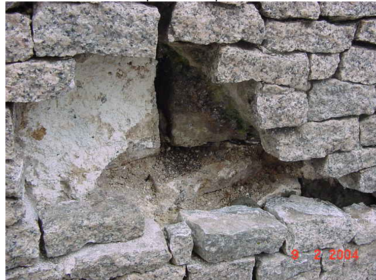
Trinca do muro frontal
