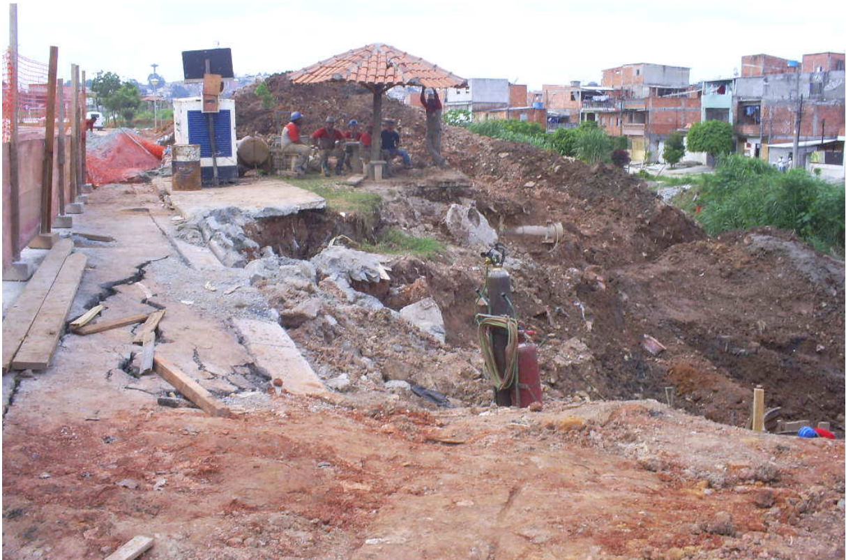
Figura 29 – As obras para implantação de adutora, realizadas pela SABESP, destruíram grande parte da área verde implantada na APP do loteamento. Mesmo a pavimentação do sistema viário cedeu em alguns pontos. Fotos de 2008.
