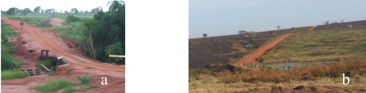
Fig.22 – P.A. Teijin, Nova Andradina, MS: a) Estrada atravessa perpendicularmente o córrego, e o escoamento superficial drena para o seu leito; b) Longos trechos de estrada em aclive cortam perpendicularmente um açude, no P.A. Avaré, Santa Rita do Rio Pardo, MS:
