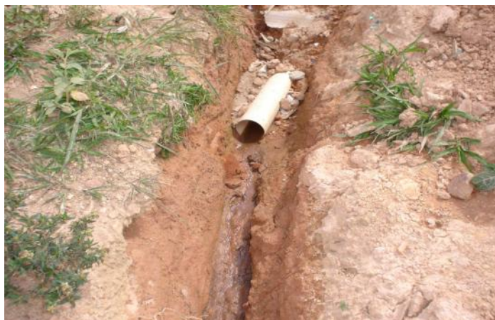
Foto 14 Improvisação de escoamento- Bairro N.S.da Guia
