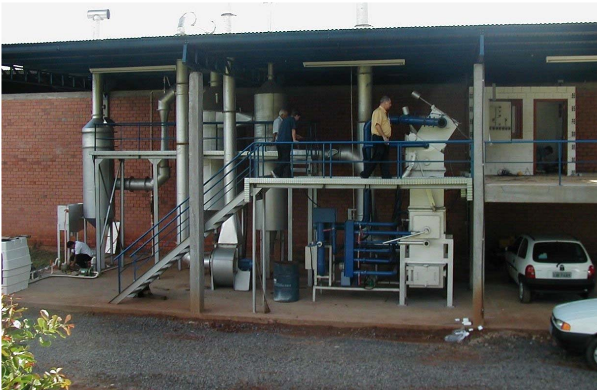
Figura 2.5: Planta piloto para tratamento térmico de resíduos de couro
