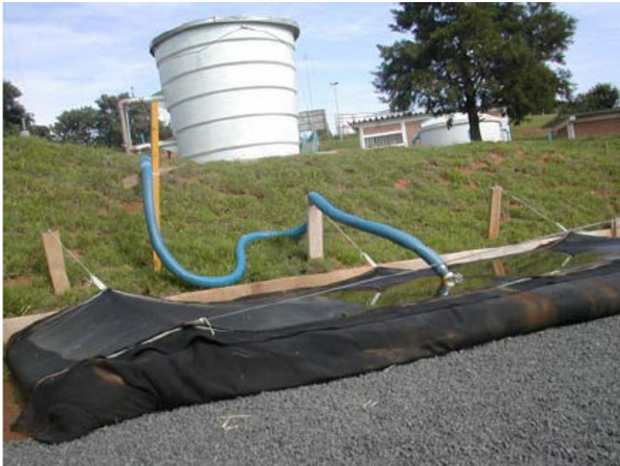
Figura 16: Tanque de equalização ligado à unidade de geotêxtil na ETA de Santo Antônio do Jardim, São Paulo
