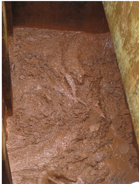
Figura 35: Lodo acumulado entre a cortina de distribuição e as paredes do decantador
