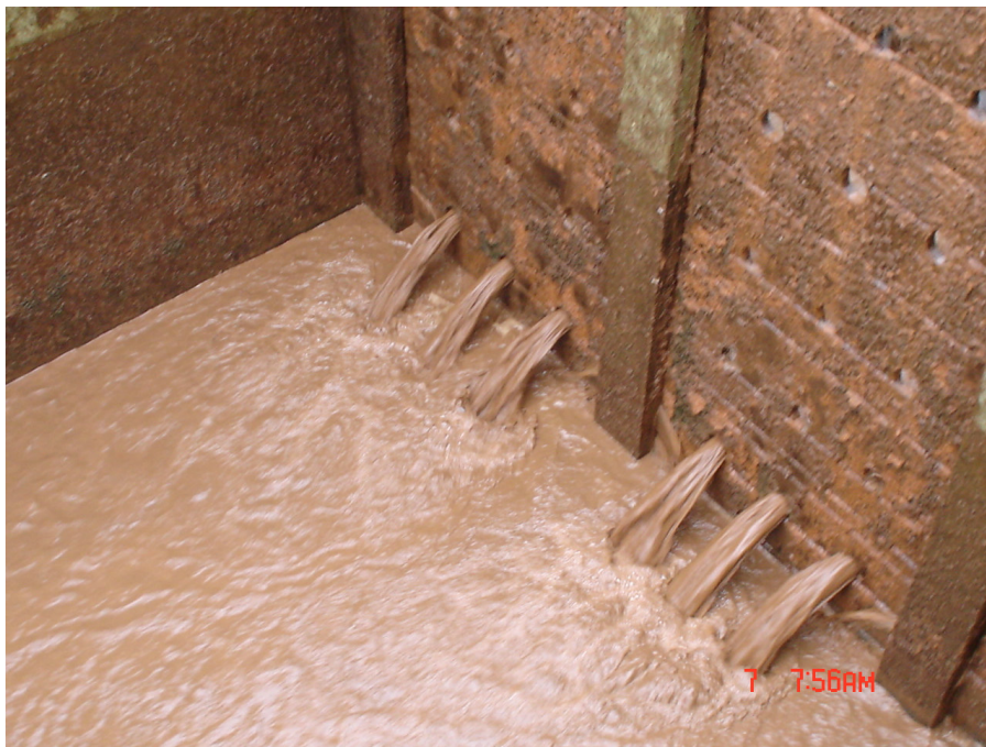
Figura 37: Passagem do lodo pela cortina de distribuição
