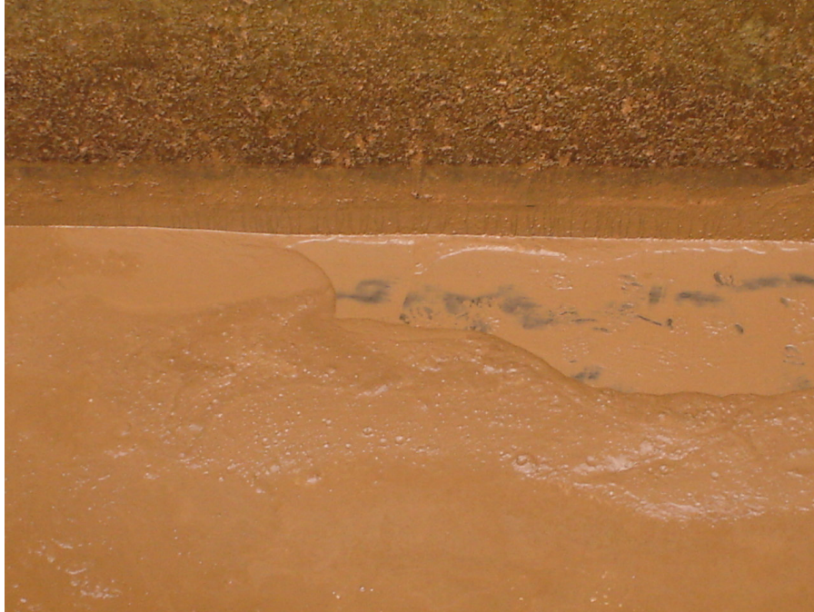
Figura 49: Marcação do lodo na parede do decantador da ETA-Itabirito
