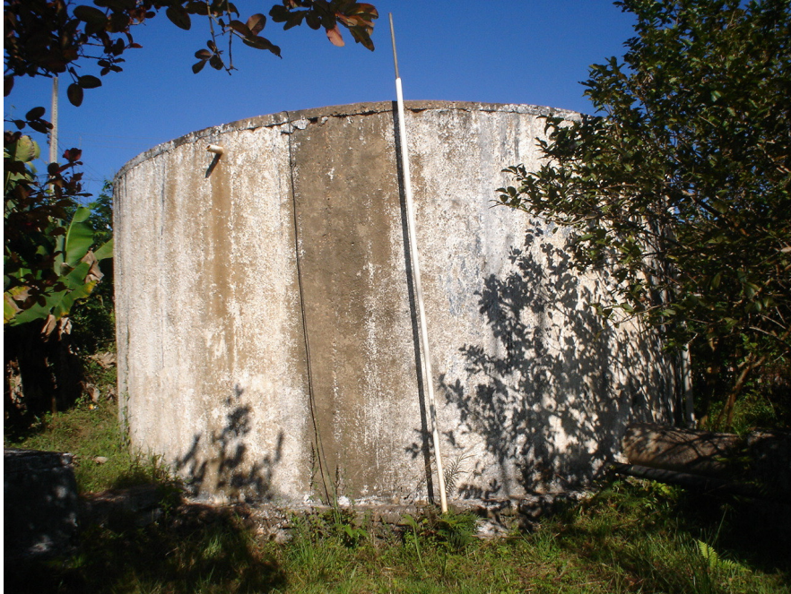
Figura 20: Reservatório de armazenamento de água para lavagem dos filtros da ETA-Itabirito
