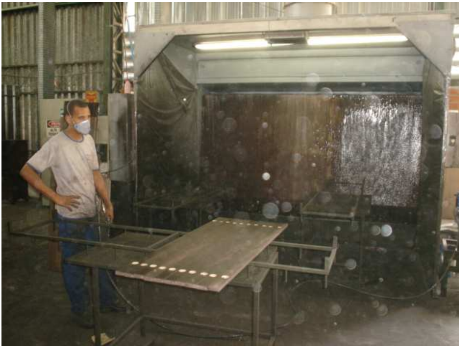
Figura 4.1 –Cabine de pintura da indústria moveleira
