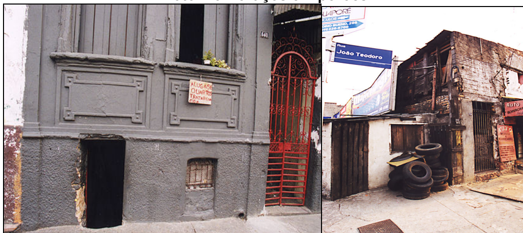
Cortiços localizados na Rua João Teodoro – Luz, com porões utilizados como moradia.
