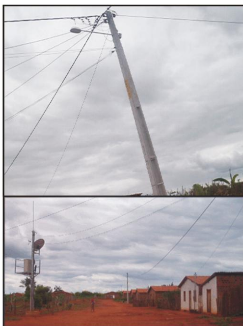
PA Baixão: Rede de energia elétrica. Foto: Paulo Coqueiro / 2006.
