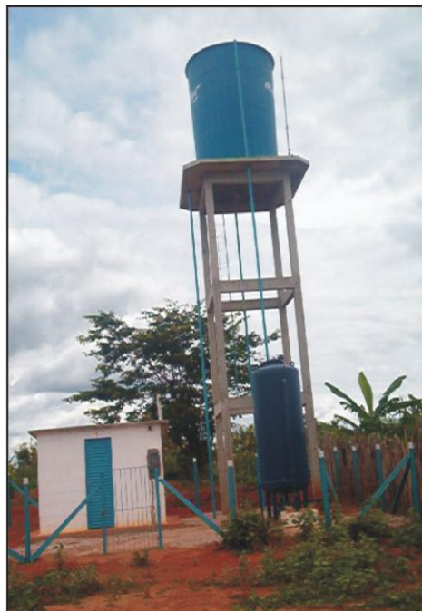
PA Baixão: Abastecimento de água. Foto: Paulo Coqueiro / 2007.
