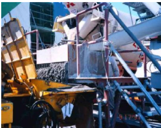
Figura 2.6 – Verificação da auto-adensabilidade do concreto no canteiro de obras (Fonte: OKAMURA & OUCHI, 2003).
