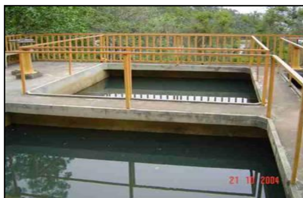
Figura 16 - ETA UFV, vista dos filtros .
