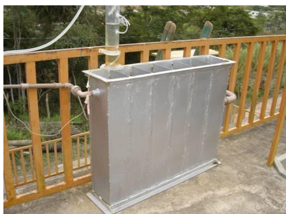
Figura 12 - ETA piloto, vista lateral do floculador.
