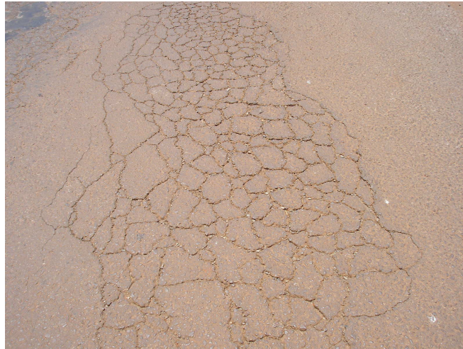
Figura 6 Foto do trincamento por fadiga
