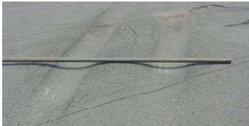
Figura 8 Exemplo de deformação permanente em pavimento asfáltico
