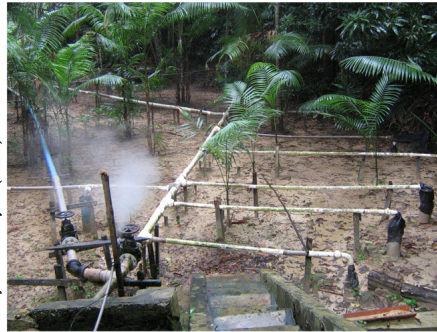
Figura 28.2 - Sistema de poços artesianos que abastecem a sede de Santa Luzia do Pará.
