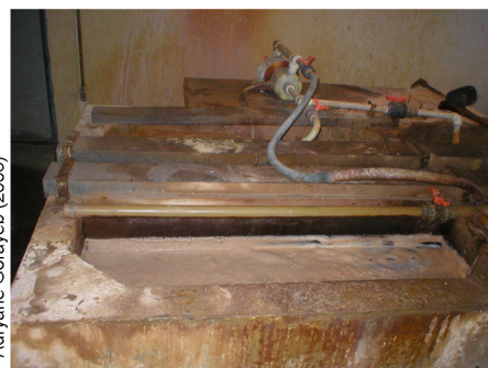
Figura 28.6 - A estrutura acondiciona a água captada, enquanto é adicionado o sulfato de alumínio, na etapa de coagulação (ETA de Bragança).
