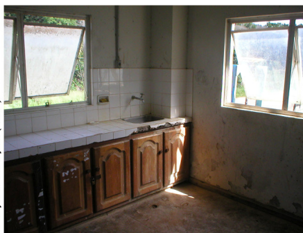
Figura 28.5 - O projeto inicial da ETA estabeleceu este local para ser o laboratório de análise da qualidade da água. Porém, a estrutura nunca foi finalizada.
