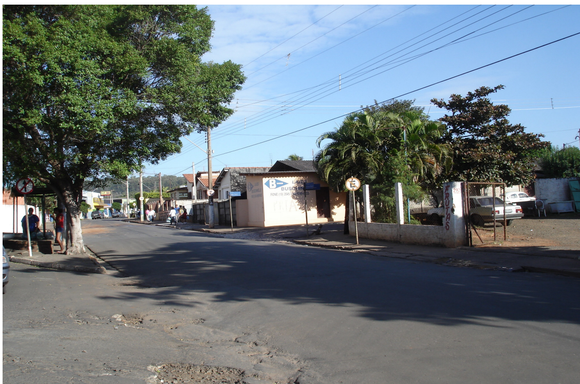
FIGURA 8: Avenida Remolo Tonon: buracos no asfalto devido ao fluxo intenso de caminhões
