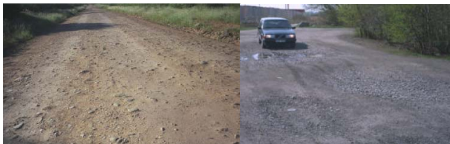
Figura 17 – Exemplos de estradas de terra em más condições.
