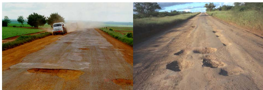
Figura 15 – Exemplos de rodovias em condições precárias.
