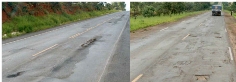
Figura 14 – Exemplos de rodovias em péssimas condições de tráfego.
