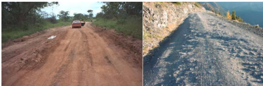
Figura 18 – Exemplos de estradas de terra em péssimas condições.
