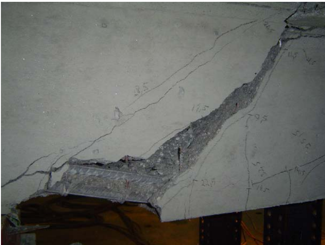
Foto A.22 – Detalhe da ruptura da viga VR1 (2).
