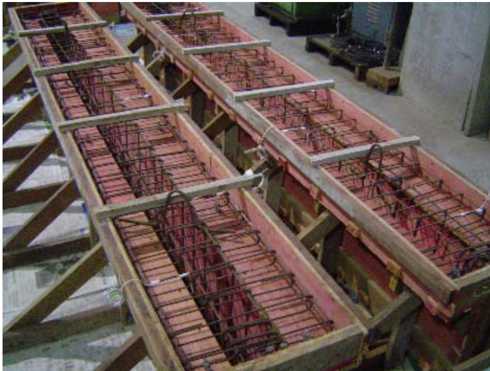
Foto A.9 – Detalhes das montagens das vigas antes do recebimento do concreto.
