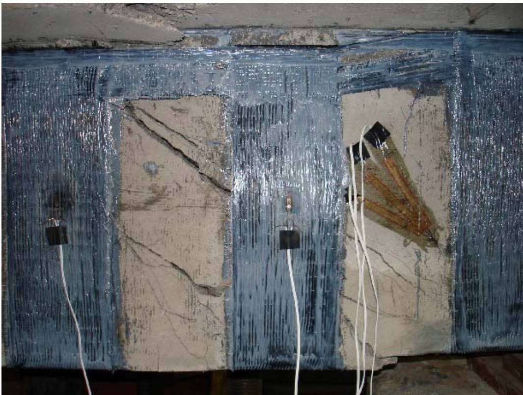
Foto A.36 – Detalhe da ruptura da viga VII-3 (2).
