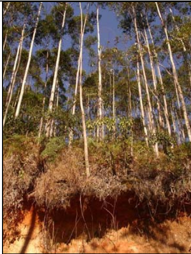
Foto 36: Erosão das barreiras na estrada
