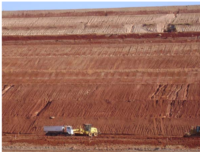
Foto: Barragem de Santo Antônio – RPM – homens trabalhando na manutenção da barragem. Foto: Aparecida F. C. Duarte, 2008.
