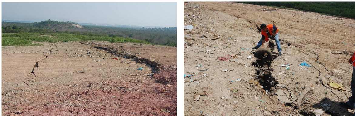
Imagens 43 e 44 – Trincas no Aterro Sanitário de Gramacho, próximo ao rio Sarapuí e em frente à Estação de Tratamento do Chorume, do lado da Baía de Guanabara (Foto Prefeitura do Rio de Janeiro).
