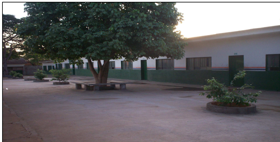
Fig. 17 - Imagem do pátio interno e pavilhão de salas de aulas da Escola Estadual Deputado "Bertoldo Freire".
