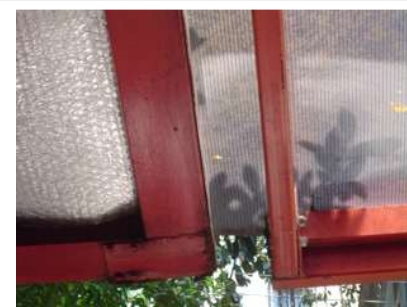
Fig. 65 - Cobertura anexa: inadequação de Tamanho, cor e textura (material)
