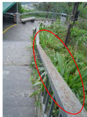
Fig.88 – Escadaria: corrosão do corrimão metálico.
