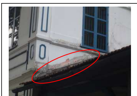
Fig. 58- Estação Inicial e Plataforma: Infiltração na fachada lateral.
