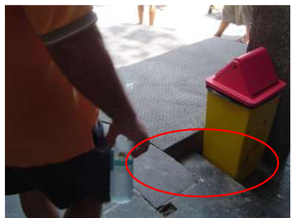
Fig.87 – Base da escadaria e base metálica: piso apresentando partes faltantes e desgaste.
