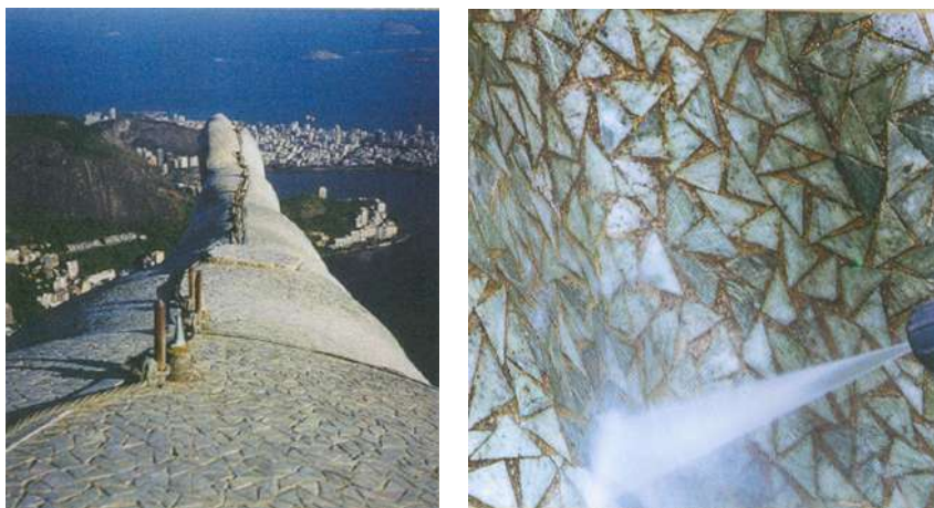
Figura 37 (esquerda) – Instalação da proteção catódica. Figura 38 (direita) – Limpeza e recuperação do mosaico. Fonte: FUNDAÇÃO ROBERTO MARINHO, 2005.
