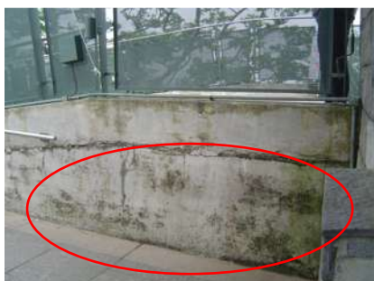
Fig.85 – Passarela: manchamentos pela presença de umidade (microflora).
