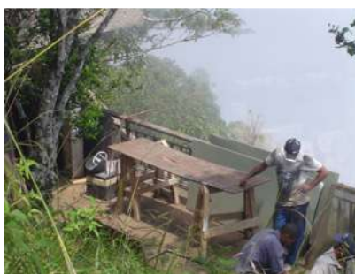
Fig. 75 – Área de mirante: canteiro de obra em local inadequado.
