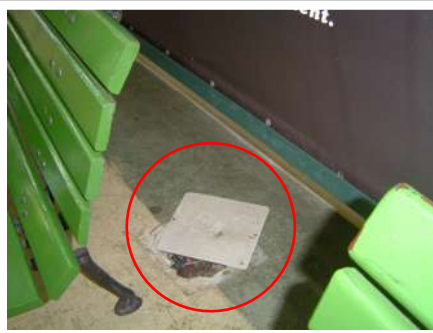
Fig.66 – Piso Centro Cultural: precariedade de isolamento nos pontos de instalação elétrica.
