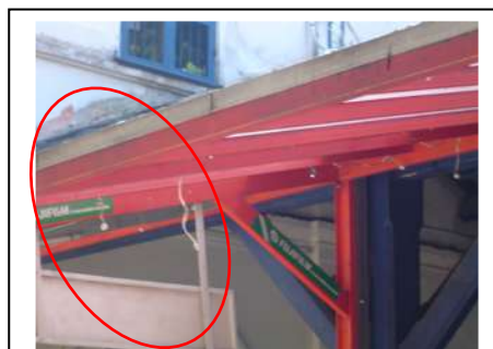
Fig.61- Cobertura anexa à Plataforma: Incompatibilidade com o entorno, infiltração e acabamento inadequado.
