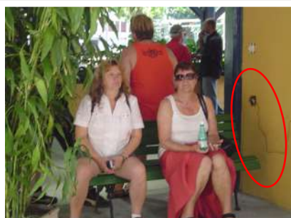
Fig.64 – Entrada/ Estação Inicial: precariedade na instalação elétrica, com fiação exposta
