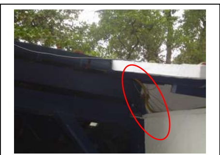
Fig.60- Plataforma da Estação Inicial: Fiação Exposta.
