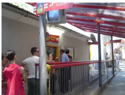
Fig.62- Bilheteria: Instalações, iluminação e acabamentos precários, inadequados e insuficientes.
