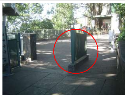
Fig.86 – Rampa na área do elevador: corrosão na chapa metálica.
