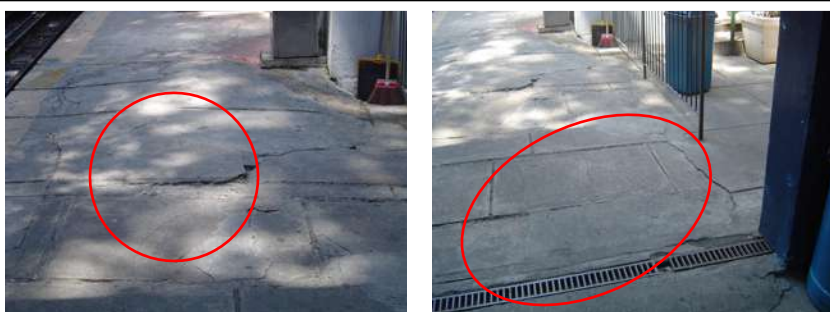
Fig.68- Piso da Plataforma de desembarque: rachaduras e partes desgastadas.
