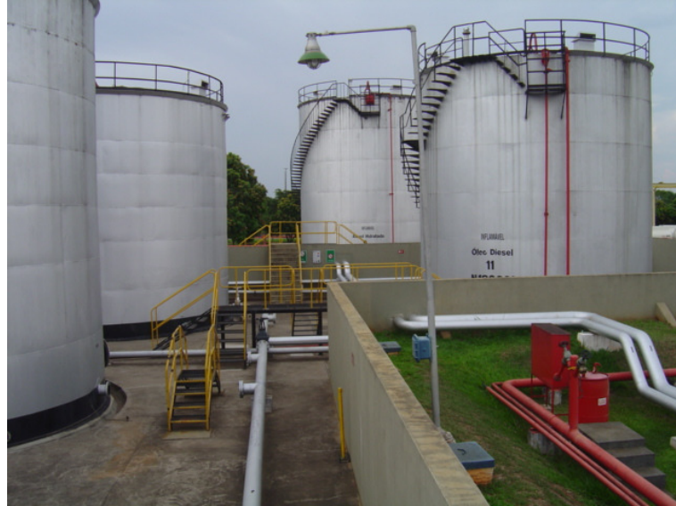
Figura 5 - Vista da interligação de tanques Fonte: Arquivo do autor
