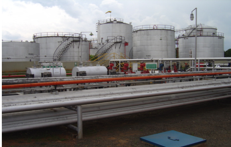
Figura 1 - Vista da área de tancagem e linhas de distribuição de produtos Fonte: Arquivo do autor
