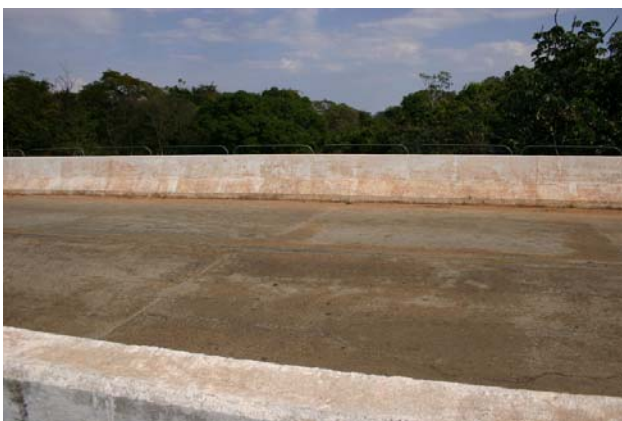
Fig. 7.40. Ponte Nova: visibilidade do rio dificultada.
