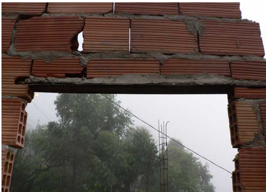
Figura 5.2 – Verga com barra de aço na junta de argamassa, usando como forma um pedaço de madeirite engastado no próprio bloco cerâmico. Fonte: Foto tirada na obra em 1998.
