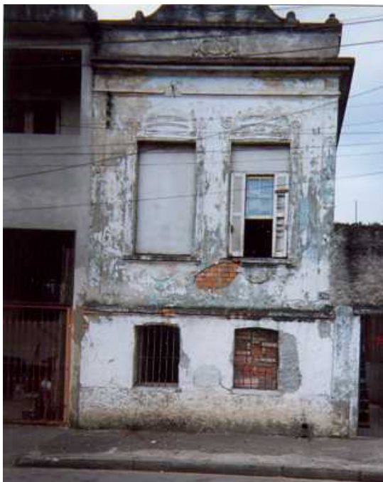
Figura 2.4 – Cortiço em São Paulo. Fonte: Uma Experiência de Mapeamento Informatizado dos Cortiços do Centro da Cidade de São Paulo. PCC/USP.Rua Vidal Negreiros, 250
