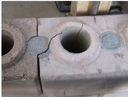
(e) trinca fora das linhas de carregamento
