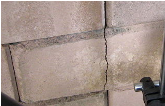
(a) trinca de face tipo 1
