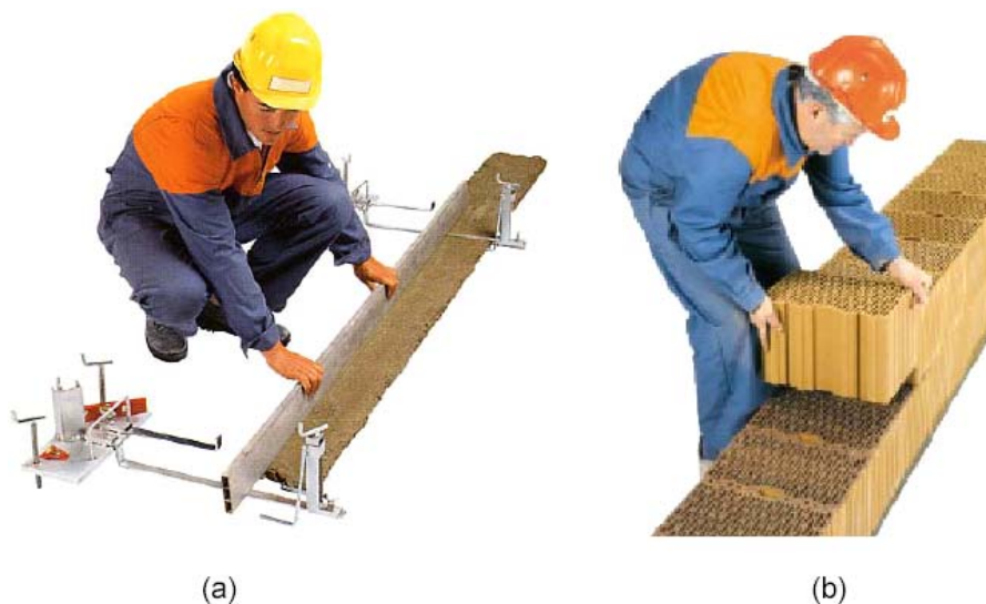
FIGURA 24 – Confeção da junta de base (a) e colocação dos blocos retificados (b). Fonte: “Catalogo 2003 Wienerberger, France”, citado por CAVALHEIRO (2004)
