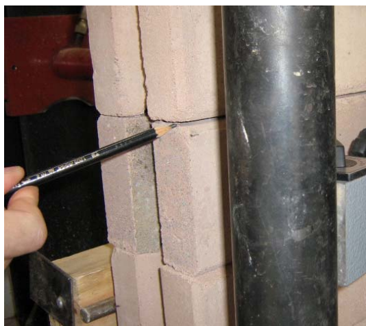
(e) ruptura entre as linhas de carregamento
