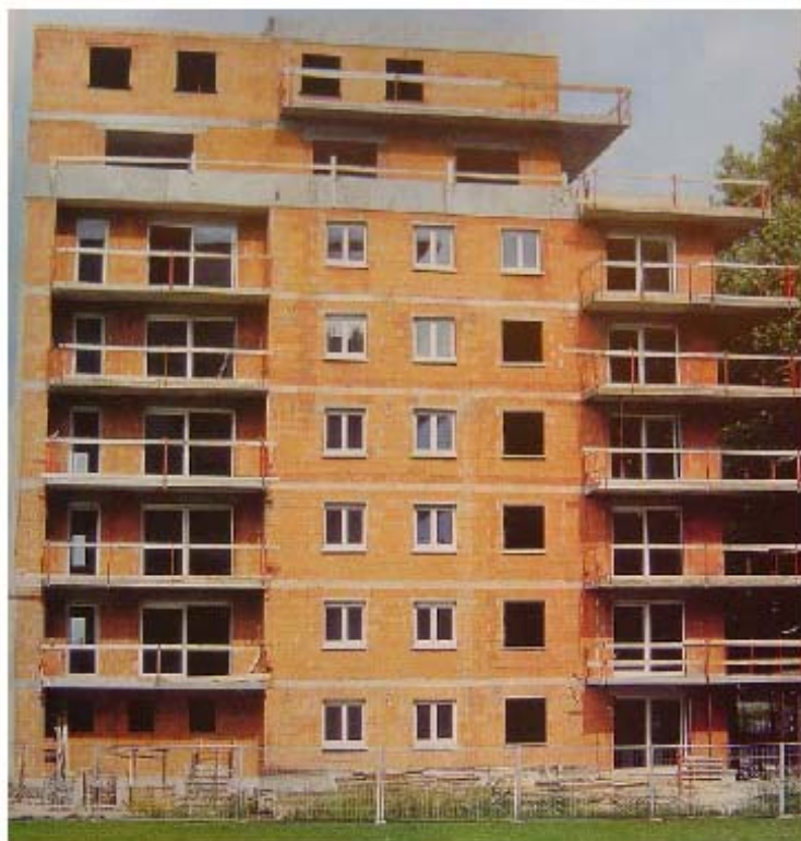
FIGURA 27 – Prédio de alvenaria estrutural na França. Fonte: “Catalogo 2003 Wienerberger, France”, citado por Cavalheiro (2004)
