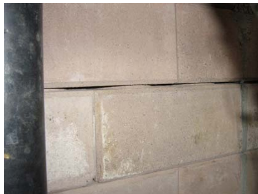
(b) abertura da junta
