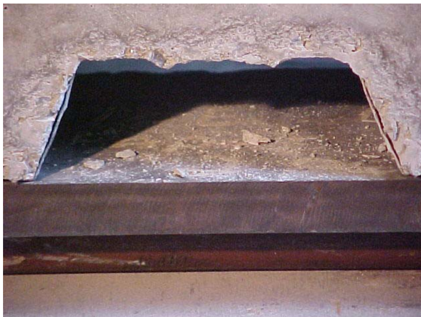
FIGURA 3.7 – Seção transversal da extremidade do modelo após colapso
