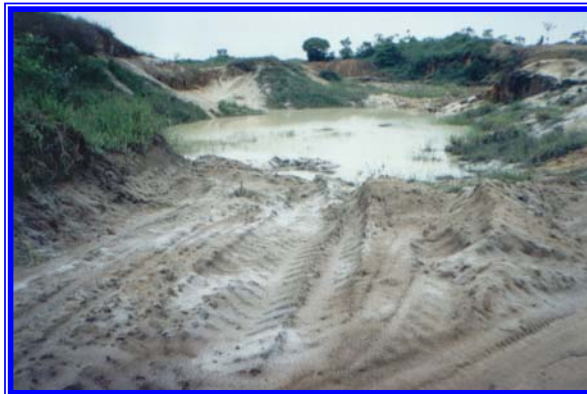
Foto 8. BR 367/BA – Subtrecho: Eunápolis-Porto Seguro. Empoçamento devido a inexistência de drenagem em areal.
