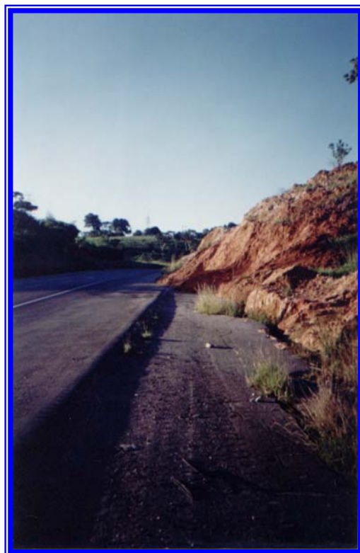
Foto 3. BR 101/BA – Subtrecho: Entroncamento BA-093 - Governador Mangabeira. Talude instável.
