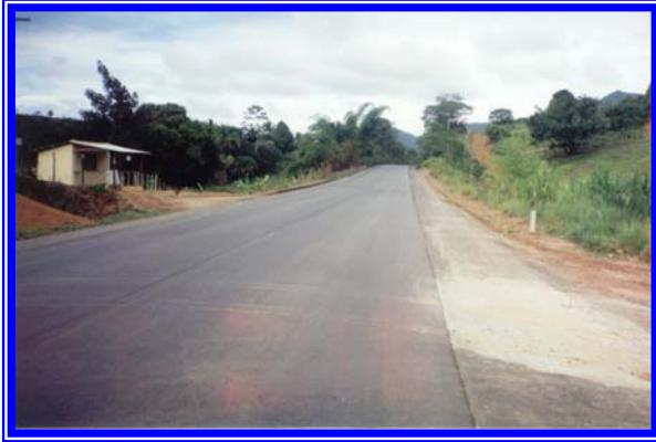
Foto 1. BR 101/BA – Subtrecho: Governador Mangabeira - Gandu. Ocupação irregular da faixa de domínio.
