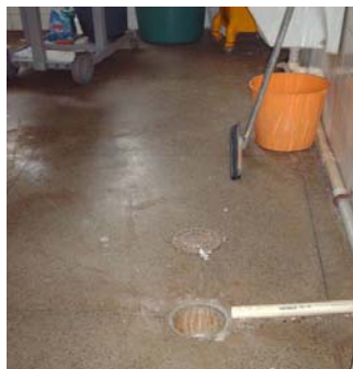
Figura 38 - Ralo e tubulação não conformes
