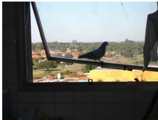
Figura 41 - Janela sem tela, permitindo a entrada de pombos
