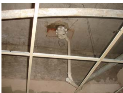
Figura 39 - Expurgo sem forro, com vazamento de água
