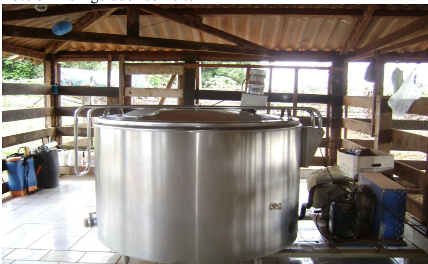
Foto 3 - Refrigerador de Leite
