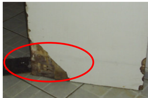
Foto 5. Porta com revestimento danificado
