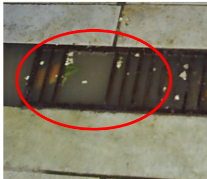
Foto 8. Canaleta sem tela de proteção e com entupimento
