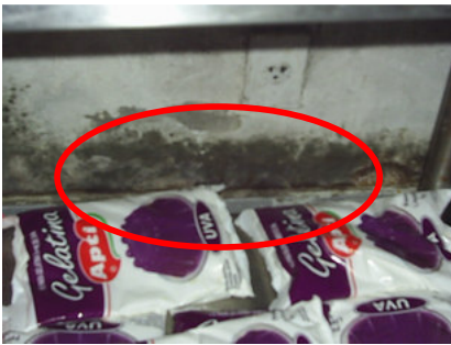
Foto 4. Parede do estoque apresentando infiltração.
