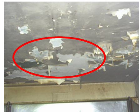
Foto 7. Teto com pintura danificada
