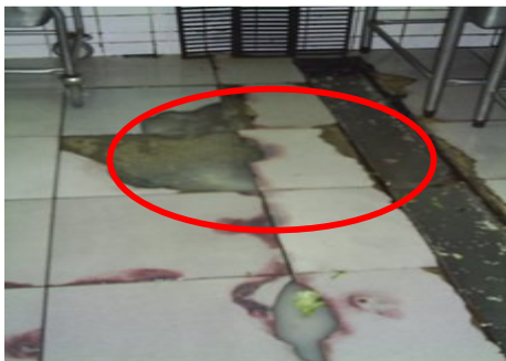
Foto 6. Piso com rachaduras e poça de água.
