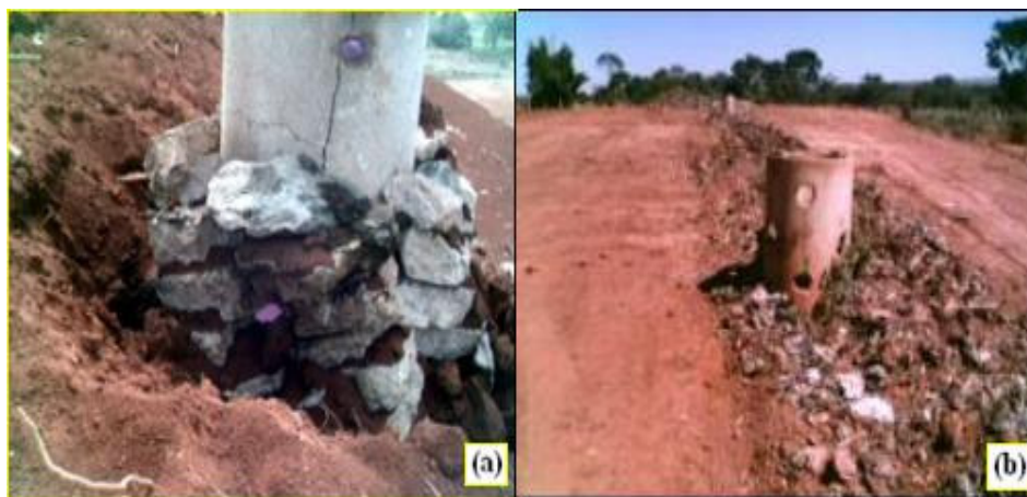
Figura 12: Drenos de gás dos aterros sanitários de Aparecida de Goiânia (a) e Anápolis (b).
