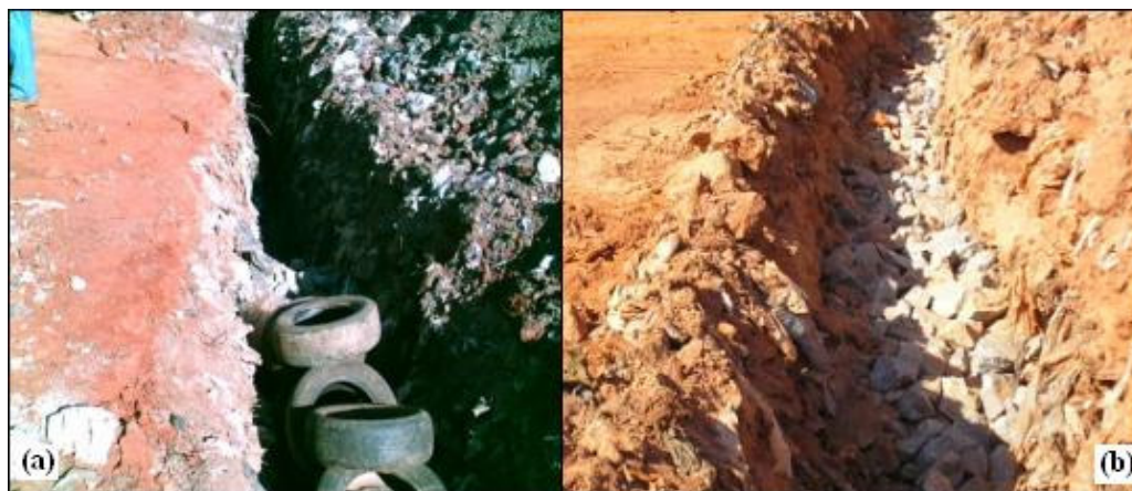
Figura 11: Drenos de percolado instalados nos aterros sanitários de Aparecida de Goiânia (a) e Anápolis (b)
