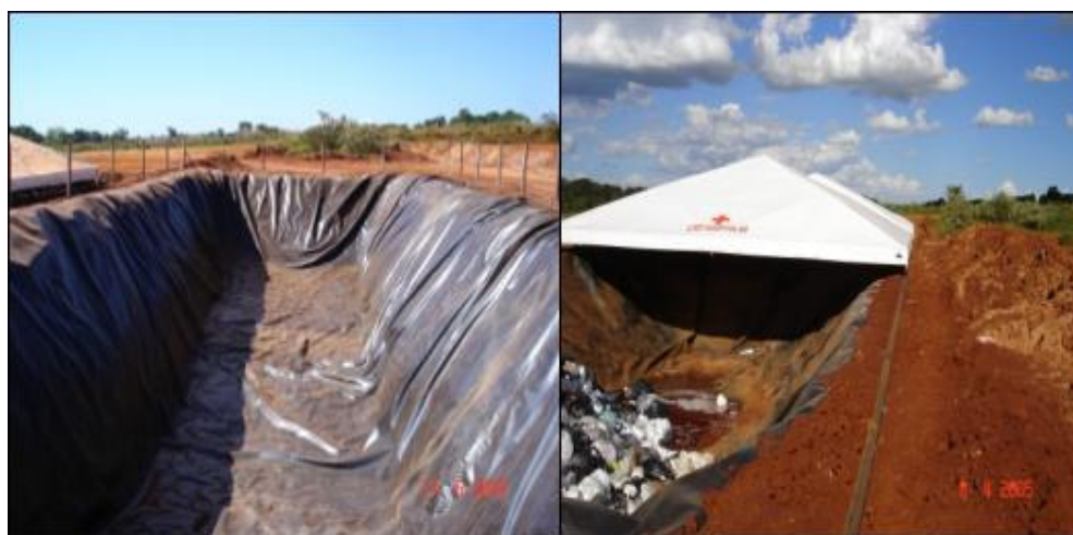
Figura 17: Detalhe da vala séptica do aterro sanitário de Anápolis, impermeabilizada e com cobertura móvel.
