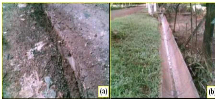
Figura 10: Detalhe das canaletas de escoamento das águas pluviais na área do aterro sanitário de Aparecida de Goiânia (a) e Goiânia (b).
