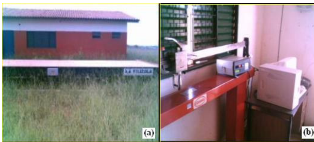
Figura 20: Instalação das balanças rodoviária. Projeto de Cidade Ocidental, detalhe externo (a) e projeto de Anápolis, detalhe interno (b).
