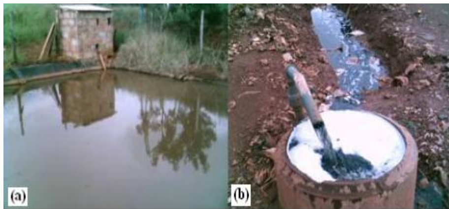
Figura 15: Bacia de acumulação do percolado com sistema de bombeamento (a); ponto de lançamento do percolado no alto do maciço do aterro sanitário (b).
