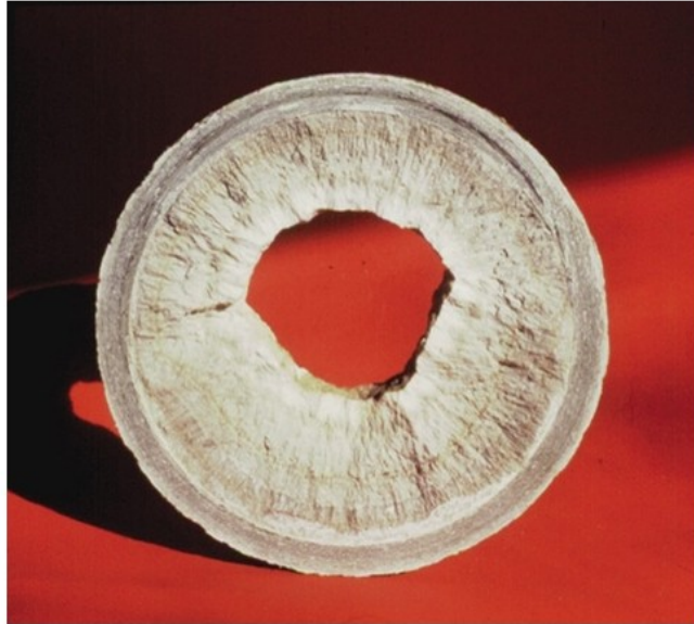
Figura 2.1 – Incrustação por carbonato de cálcio em uma tubulação (GENTIL, 2003)
