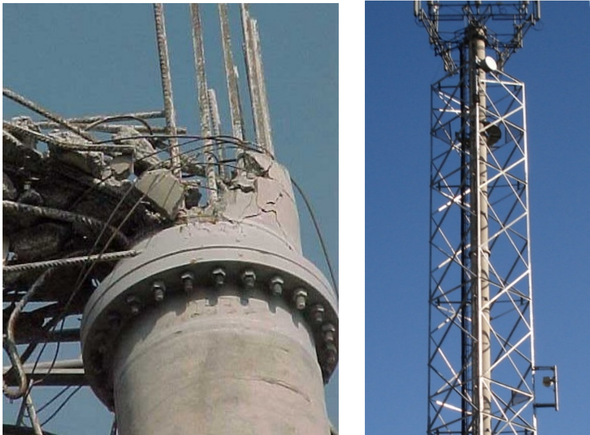
Figura 4 – a) Exemplo de acidente ocorrido na região da ligação de poste de concreto (SOUZA 2005) b) alternativa de reforço de torres de concreto.
