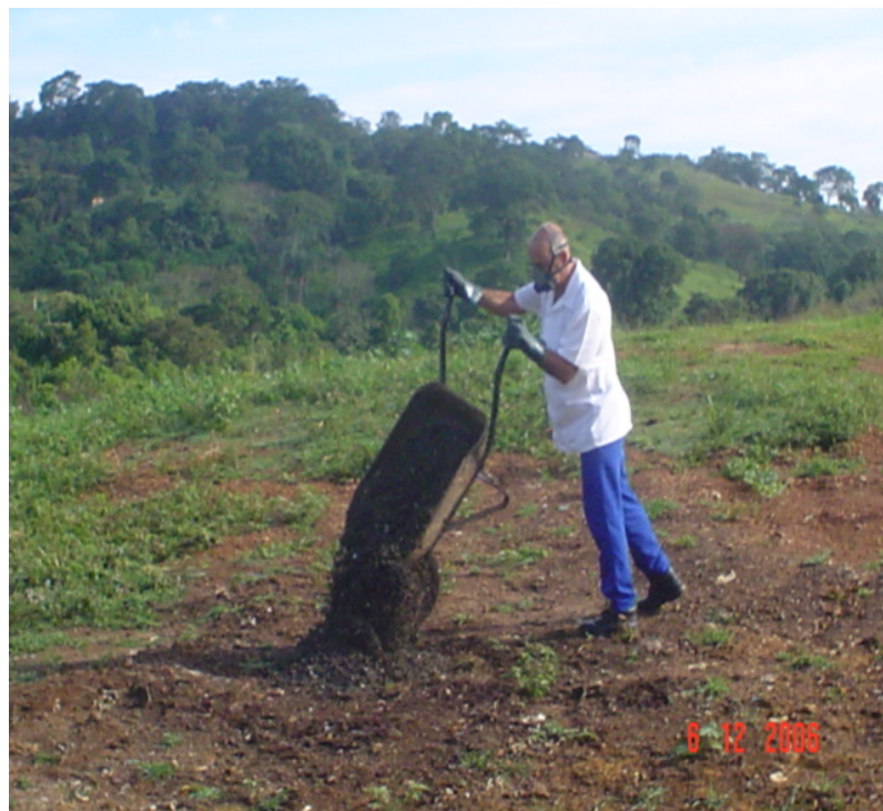
Fotografia 16 Vista da operação de transporte da areia retirada na limpeza do desarenador
