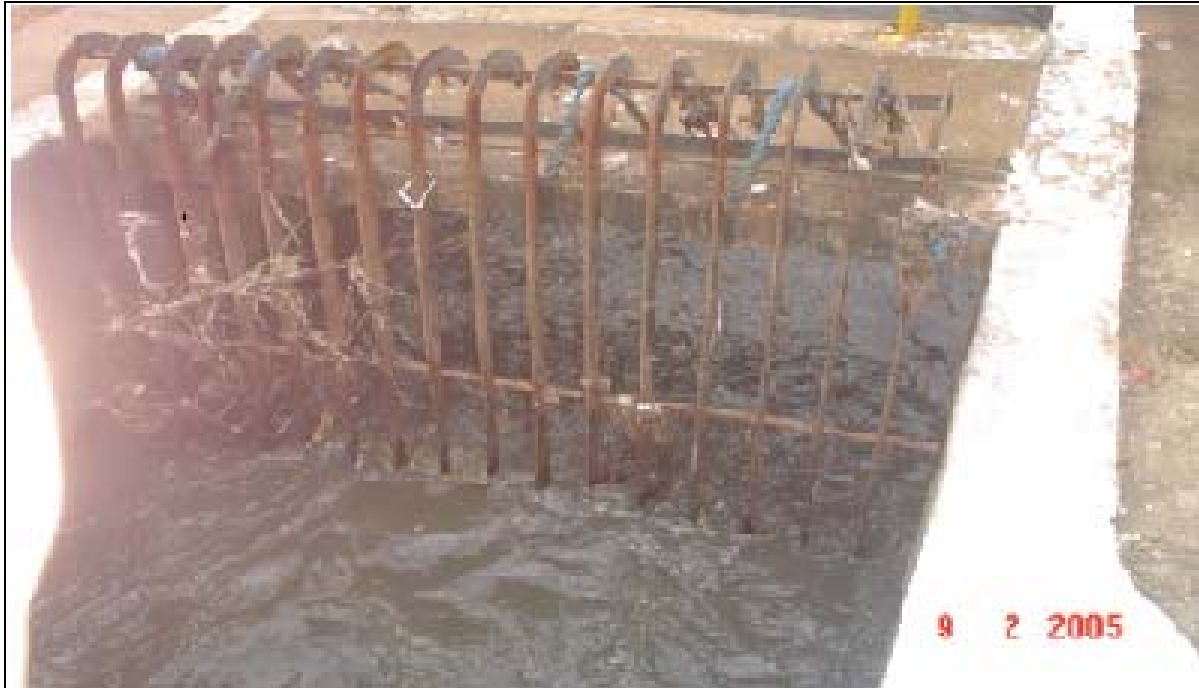
Fotografia 2 Vista da grade grosseira da ETE–Anápolis
