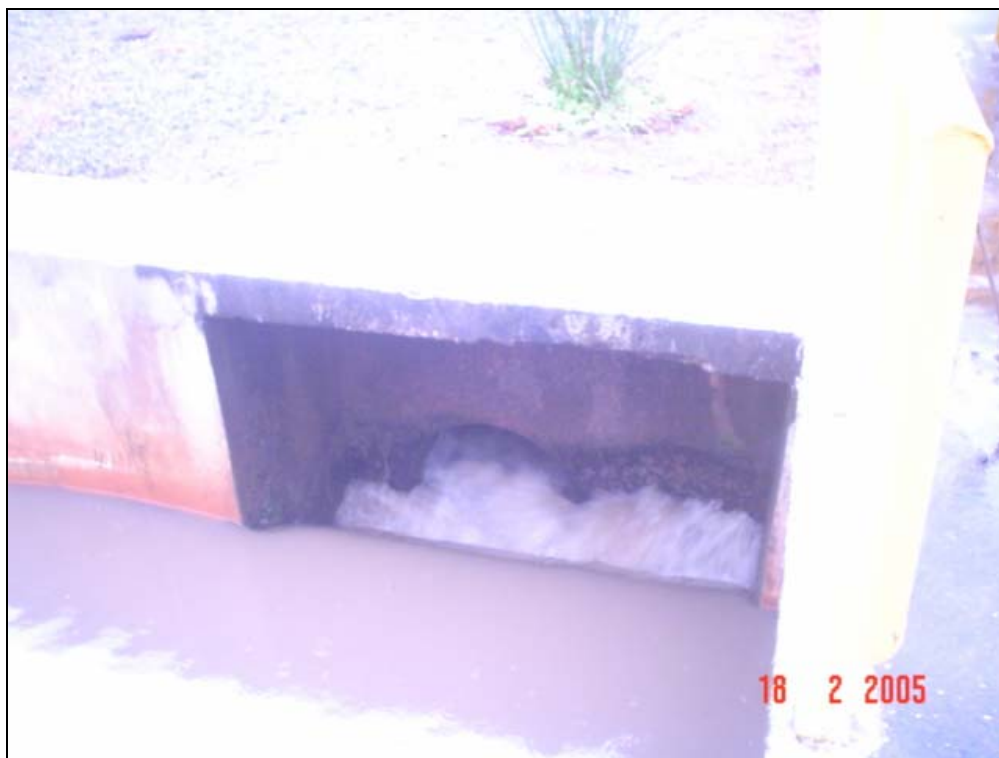
Fotografia 14 Vista parcial do bypass a montante do poço de sucção, após intensas precipitações
