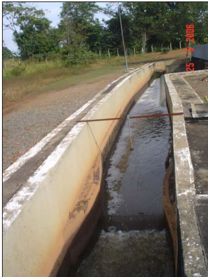
Fotografia 5 Vista do medidor de vazão da ETE–Anápolis (Calha Parlhall, W = 4 pés)
