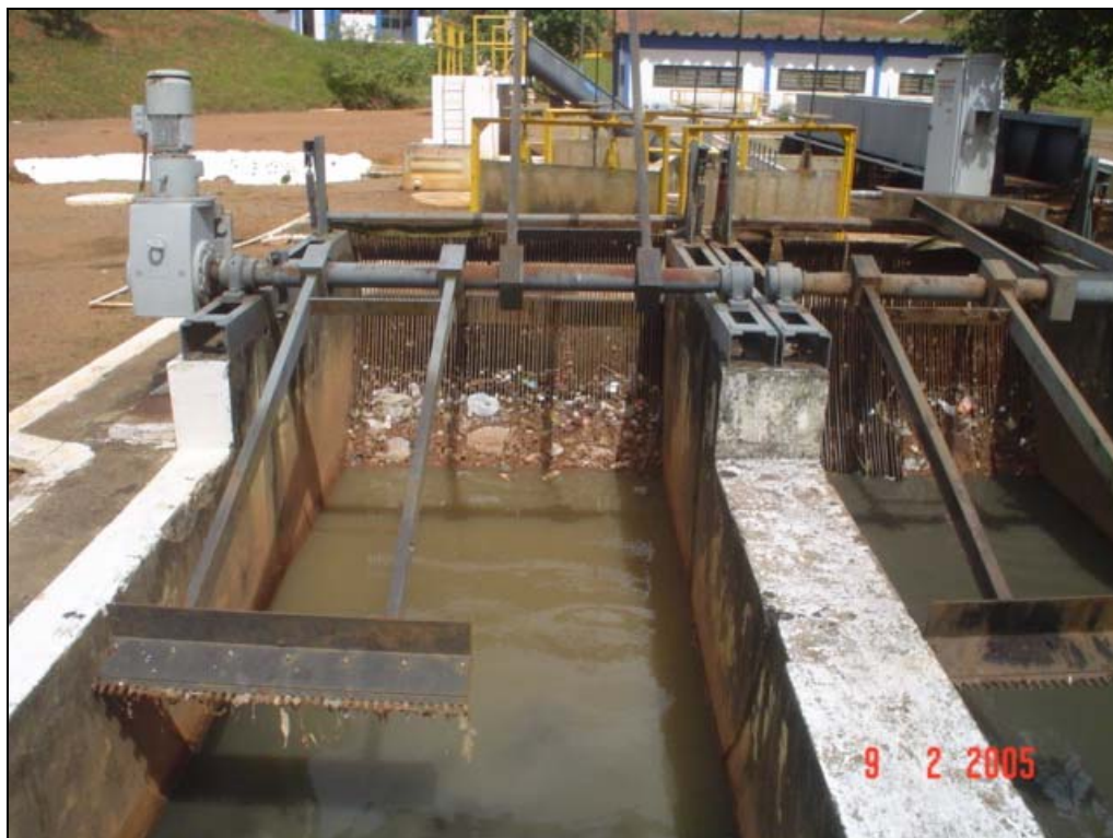
Fotografia 6 Vista do gradeamento fino da ETE–Anápolis
