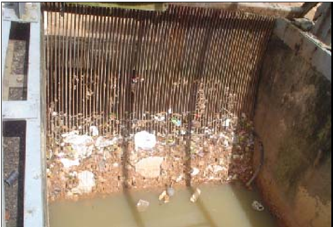
Fotografia 3 Vista da grade fina da ETE–Anápolis
