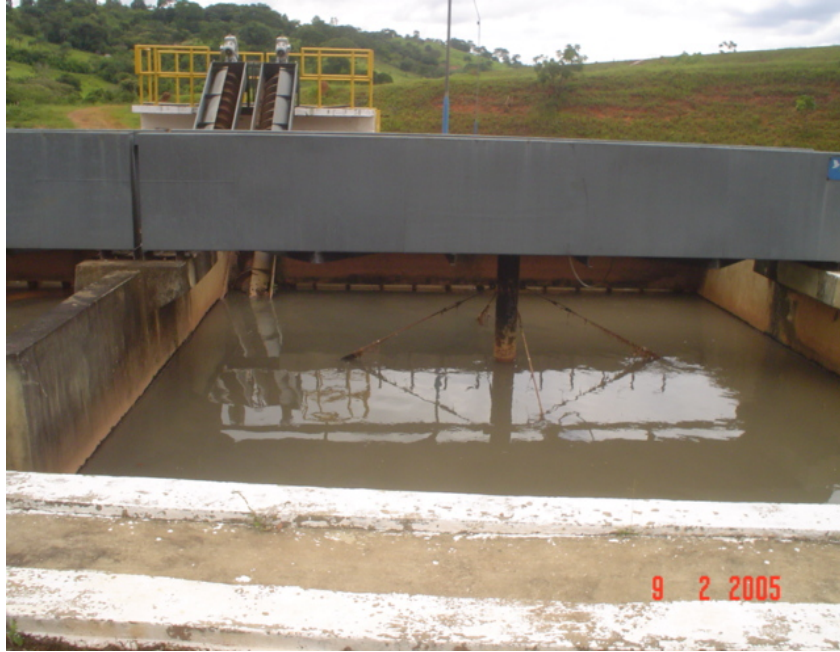
Fotografia 4 Vista do desarenador da ETE–Anápolis
