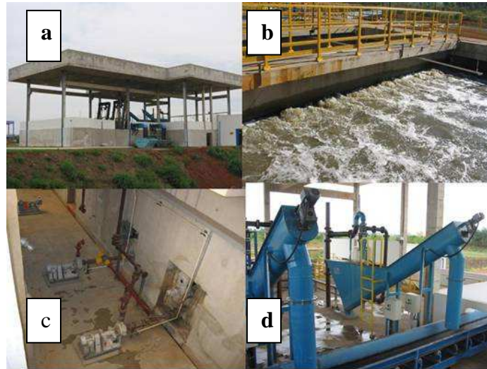
Figura 6 – Caixa de areia aerada – ETE – Goiânia: a) vista do prédio ; b) vista de uma unidade; c) detalhe das bombas de sucção de areia; d) vista do classificador de areia.
