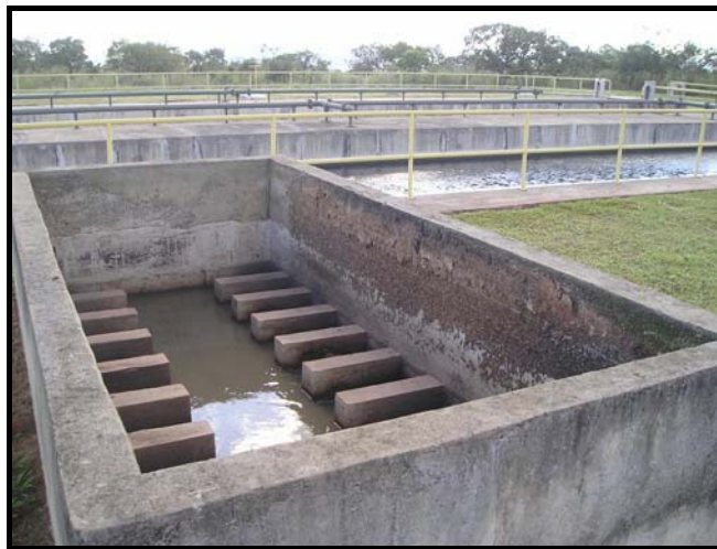
Figura 5.12 – Caixa de distribuição de vazão afluente aos reatores anaeróbios da ETE Gama.
