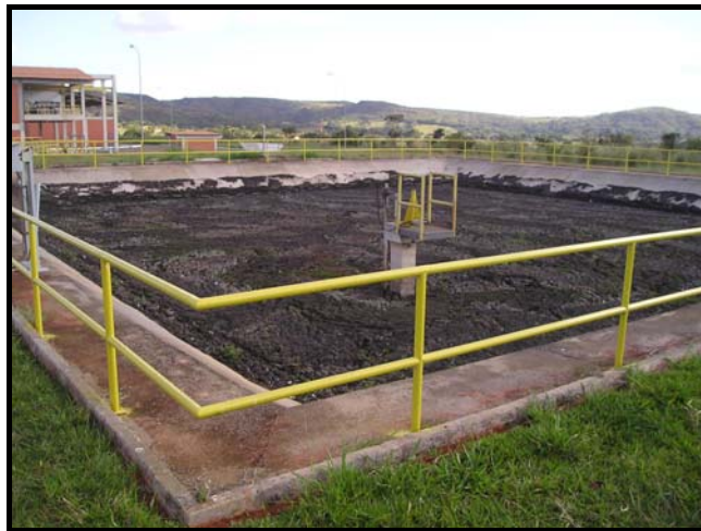
Figura 5.19 – Vista parcial da lagoa de lodo da ETE Gama.
