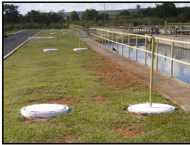
Figura 5.17 – Vista do sistema de descarga de lodo dos reatores anaeróbios da ETE Gama.
