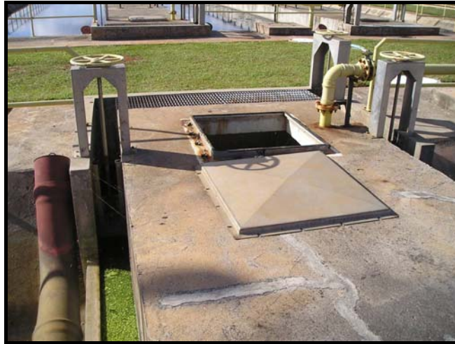
Figura 5.18 – Vista do sistema de remoção de espuma dos reatores anaeróbios ETE Gama.
