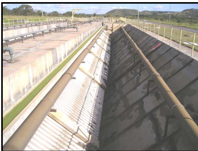
Figura 5.15 – Vista parcial das tubulações de distribuição e coleta dos esgotos e sistema de diluição e descarga de lodo dos reatores anaeróbios da ETE Gama.
