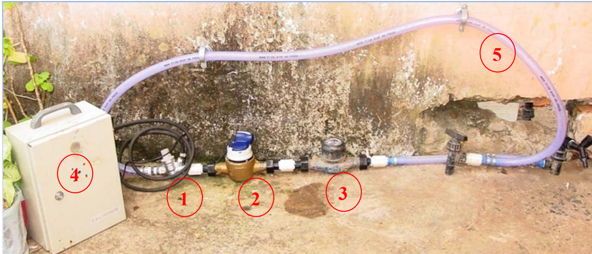
Figura 4.2– Instalação dos equipamentos para registro de vazão e pressão (1 = VPR; 2 = Hidrômetro volumétrico; 3 = Hidrômetro velocimétrico original; 4 = Caixa contendo o data logger de vazão e o de pressão e baterias auxiliares; 5 = mangueira flexível)
