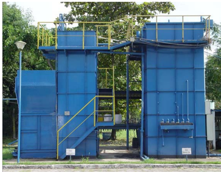
Figura 4.1: Estação de Tratamento de Esgoto da UFES.
