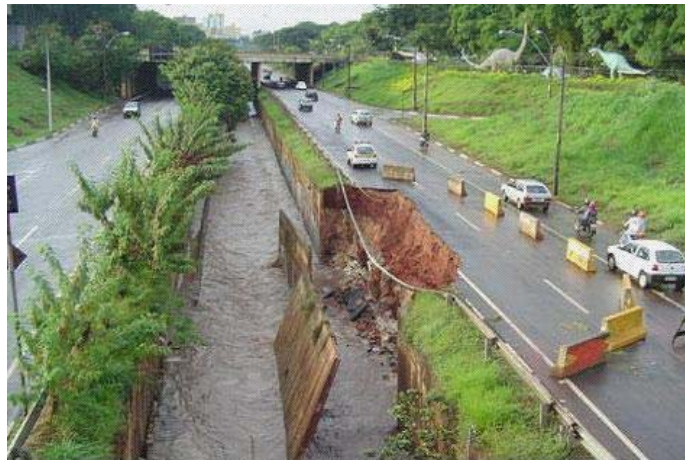
Figura 5.20: Desmoronamento na Marginal Botafogo, Março de 2003
