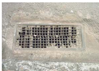
Ilustração 41 - Boca de lobo com grelha não padronizada
