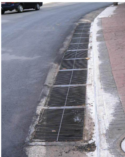
Ilustração 13 - Boca de lobo disposta sob a sarjeta
