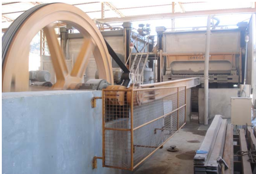
Figura 3 - Tear com sistemas de corte com movimento pendular do conjunto de lâminas de aço arrefecido com polpa abrasiva de granalhas de aço e cal (Cachoeiro de Itapemirim, ES – foto do autor)
