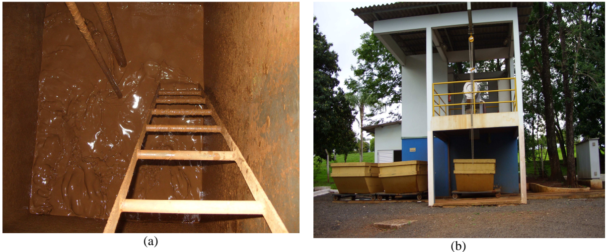
Figura 3.3 – (a) Lodo sendo descarregado pelo decantador, (b) Maquinário de centrifugação com acondicionamento em contêineres.
